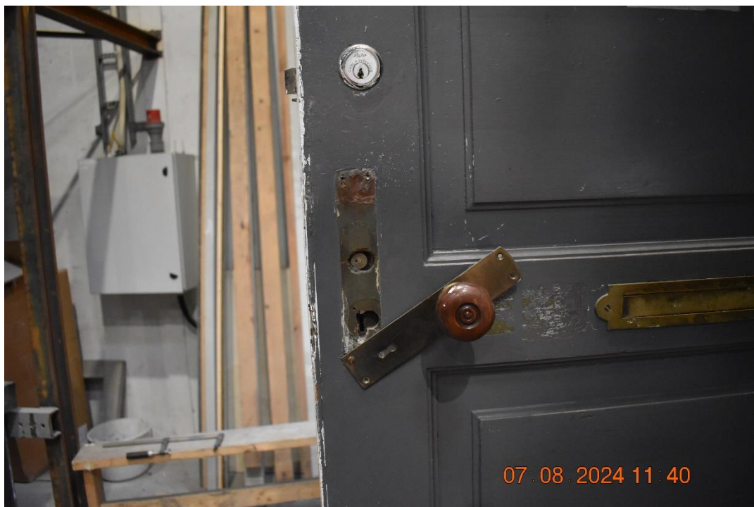
Foto nr. 11 Udskeeringer i dørplade til tidligere låseslag/nøglehul.
