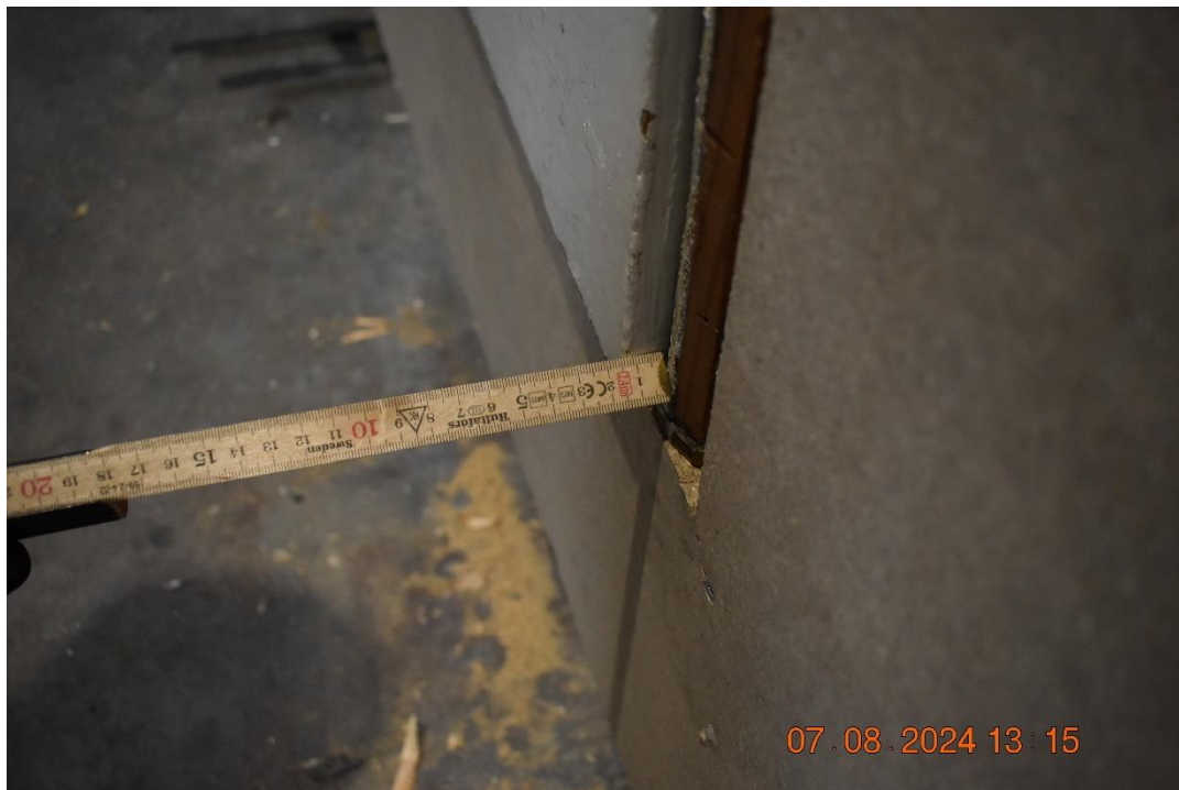
Foto nr. 13 Udbøjning i bund af dørpladens låseside. Tætningslisten flyttes, så den følger med dørpladen.
